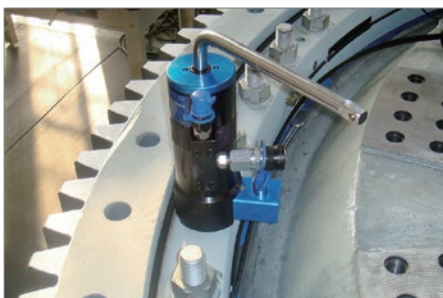
風車ブレードのベアリングボルト
