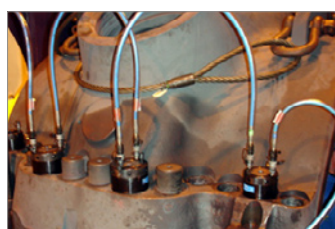
M100タービンケーシングボルト
